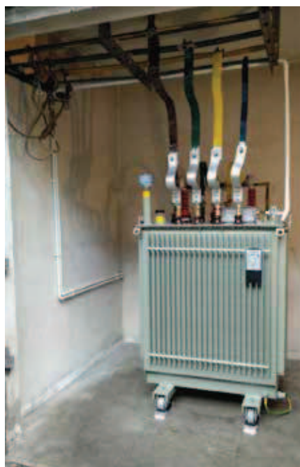
Rys. 2. Transformator 15/0,5 kV 400 kVA z PPZ na stanowisku
