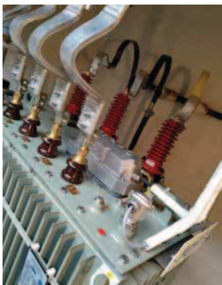
Rys. 3. Widok górnej części transformatora 15/0,5 kV 400 kVA z PPZ – widoczna głowica napędu pomiędzy przepustami SN i nn
