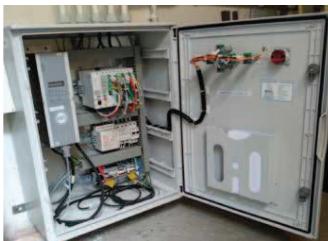
Rys. 1. Wnętrze szafy ARN w stacji SN/nn
