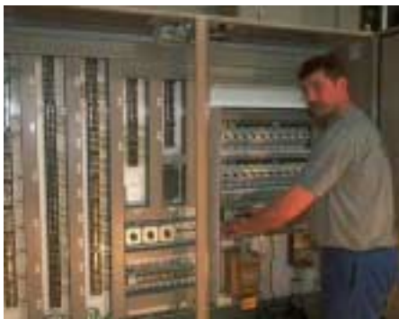
Essai fonctionnel de l'installation secondaire
